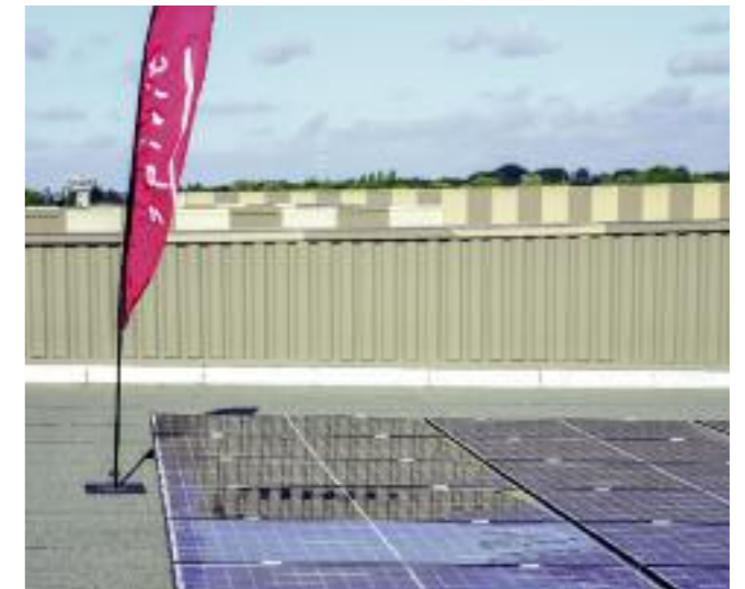
Panneaux photovoltaïques sur le toit du Spirit Business Cluster, Tremblay-en-France - AeroliansParis - Grand Paris Aménagement, Anne Carcelen Architecture et Land'Act.
