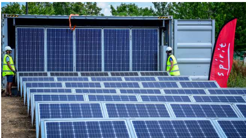
Spirit déploie le Solar GEM® pour alimenter en énergie photovoltaïque son chantier du Parc Spirit du Mantois, situé au cœur du quartier Mantes Innovaparc à Buchelay (78)
